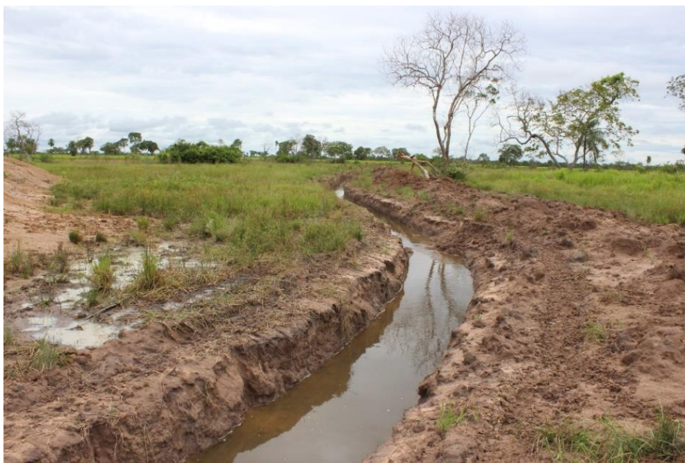
Figura 1. Vista de uma obra de drenagem na planície pantaneira do município de Cáceres, Mato Grosso.
